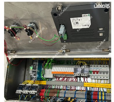
تابلو برق پیشرفته
